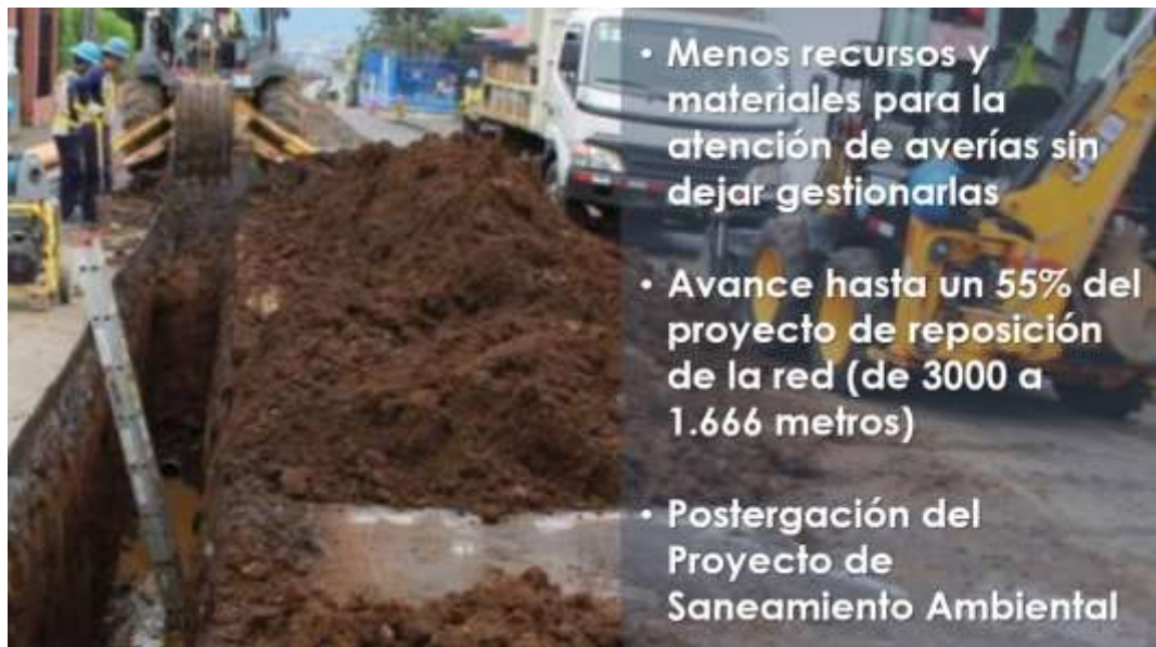
Servicio Alcantarillado Sanitario
