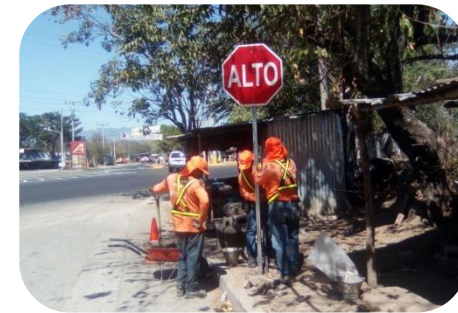
Señalización y demarcación
